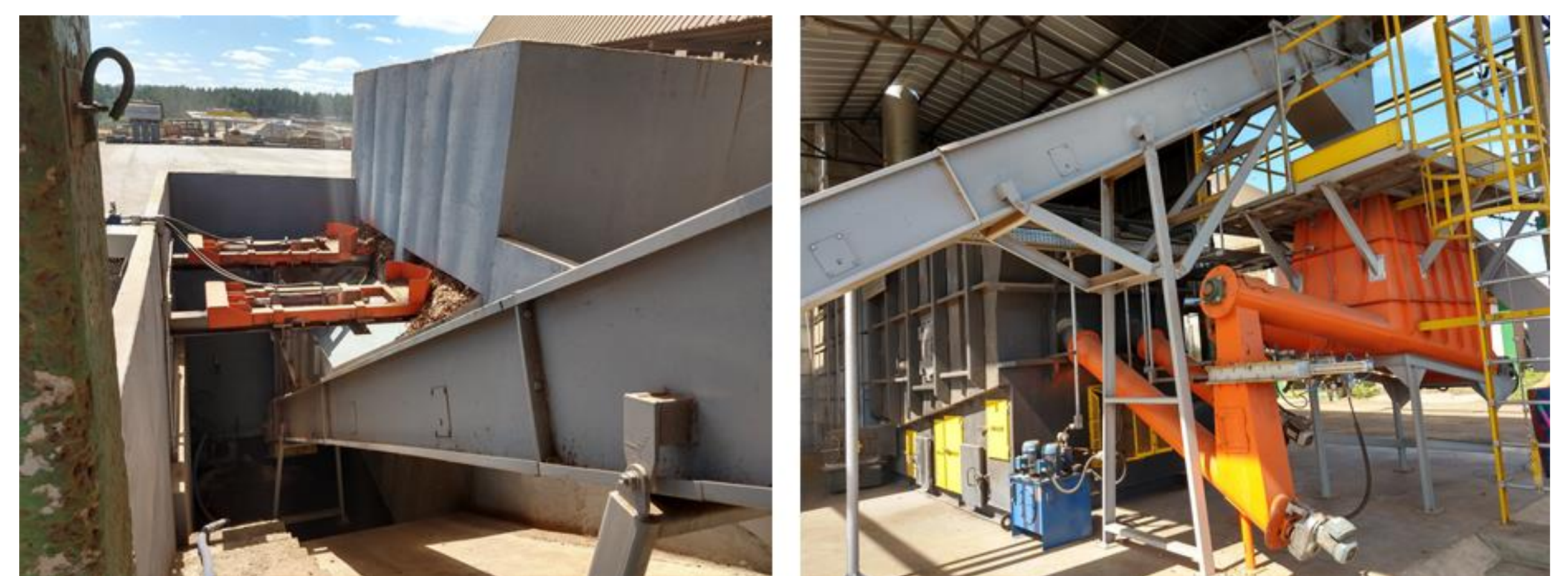
Figura 2 – Sistema de Abastecimento Automático
