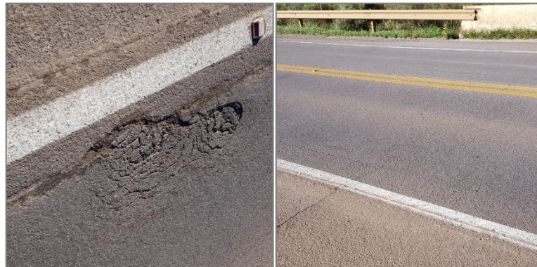
Figura 48: Ponte 1 - Condições do pavimento no dia do ensaio.
