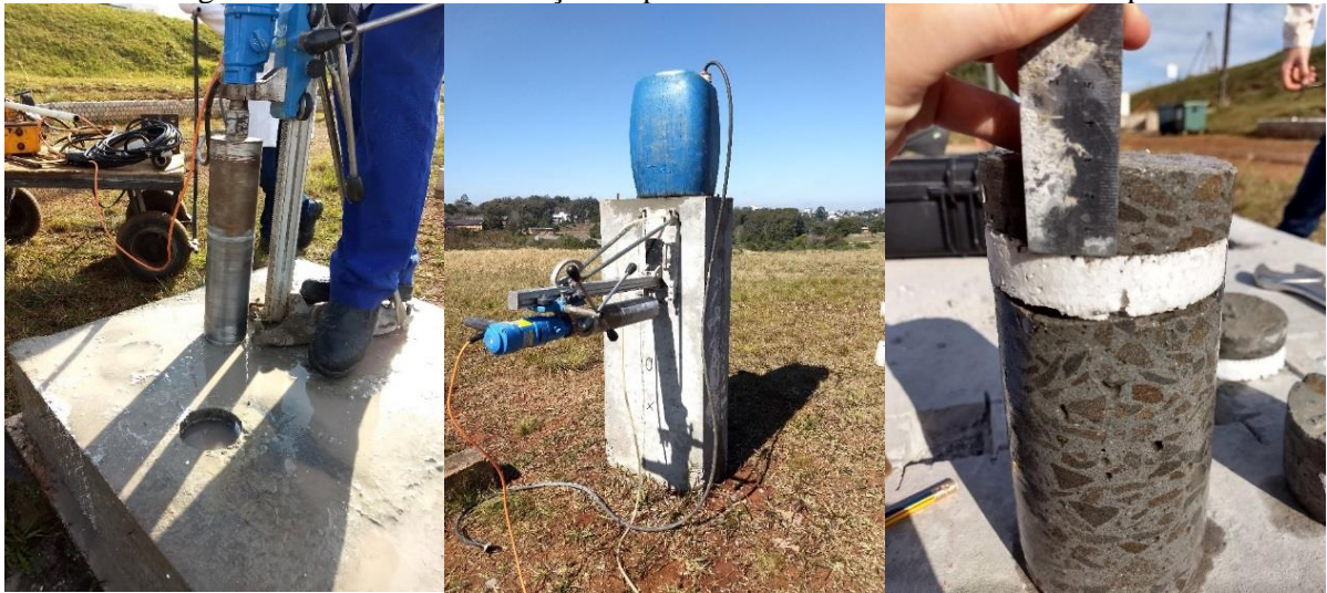
Figura 36- Ensaio de verificação de profundidade dos danos com serra copo
