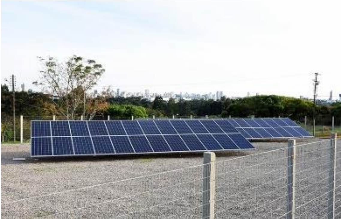
Figura 8 – Painéis Solares existentes localizados na UPF.
