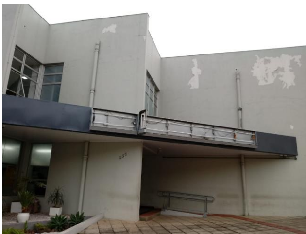
Figura 28: Letreiro que foi removido o policarbonato.
