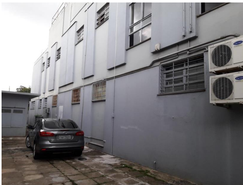
Figura 33: Parede apresentando avarias antes da recuperação e execução de pintura.
