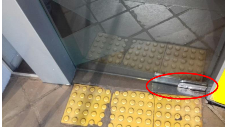
Figura 30: Detalhamento da mola de piso avariada.
