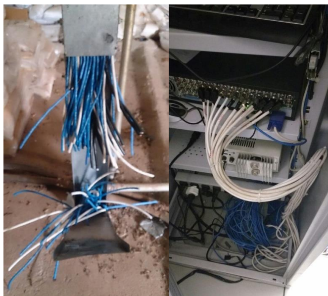
Figura 26: Cabeamento estruturado avariado e após a sua substituição a) Cabeamento estruturado avariado b) Cabeamento estruturado substituído
