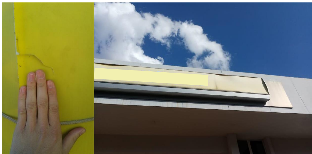
Figura 29: Detalhe da chapa de policarbonato quebrada e com dimensões incorretas
