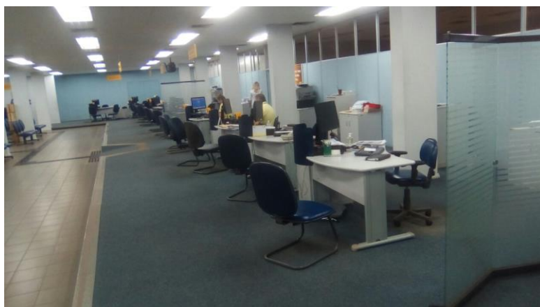
Figura 20: Vista panorâmica de um elevado contendo carpete avariado.
