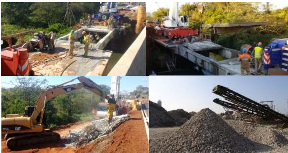
Figura 52 - Etapas de demolição de ponte Fonte: America Perfurações e Cortes em Concreto (2019); Torres (2017)
