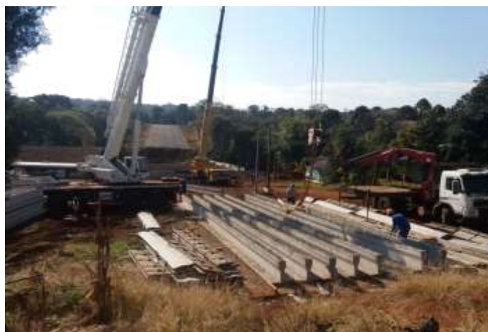
Figura 16 - Canteiro de obras para construção de uma ponte Fonte: Produzido pelo autor (2019)
