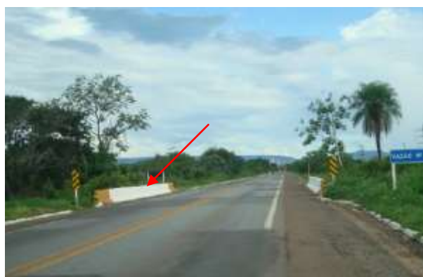
Figura 38 - Pintura em uma ponte Fonte: Ministério dos Transporte (2016, p.15)
