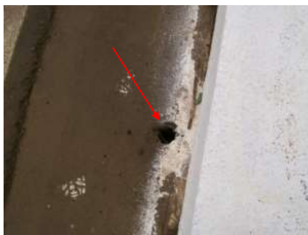
Figura 36 - Dreno em uma ponte Fonte: Produzido pelo autor (2019)
