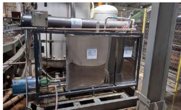
Figura 7: Piloto instalado in loco .
